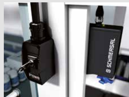
Acquisizione automatica dopo l'inserimento della tensione d'esercizio
